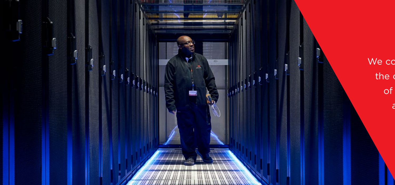
PA4 Paris IBX® Data Center
